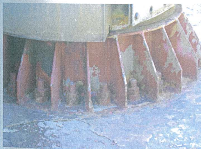
Fot. 16. Złuszczona farba na elementach stopy przewodu
