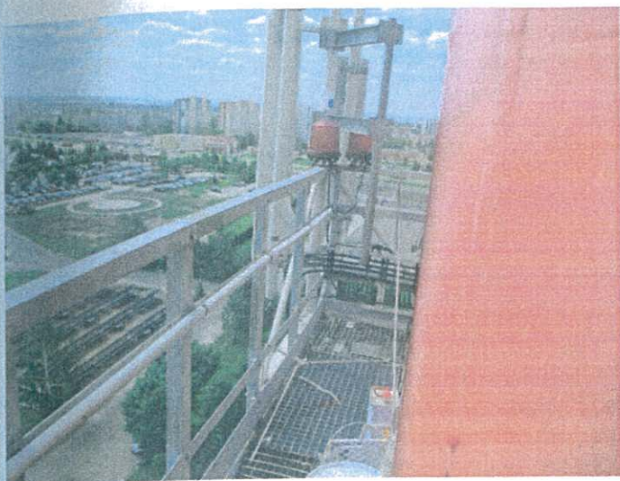
Fot. 6. Widok elementów galerii w górnej części kominia
