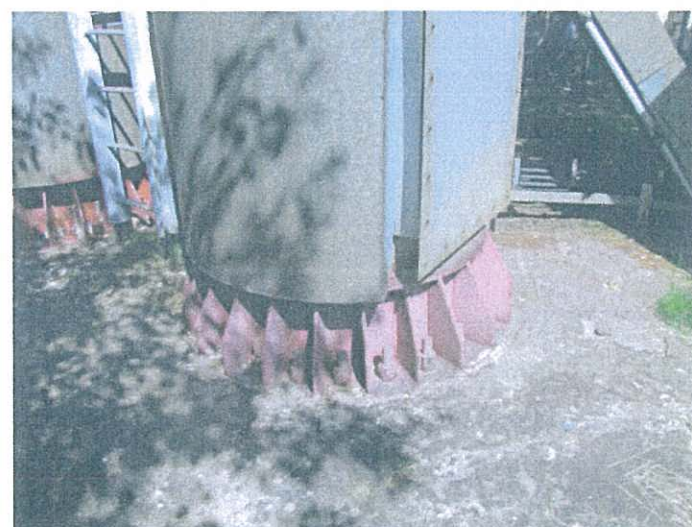
Fot. 17. Fundament pod kominy. Widoczne zruszczenia i spękania wierzchniej powierzchni betonu
