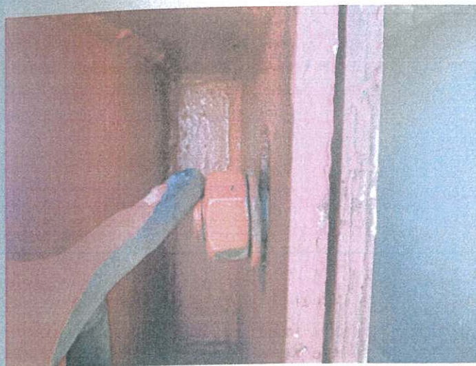
Fot. 12. Zapewnienie przesuwu przewodu względem rury nośnej – luźna śruba w owalnym otworze
