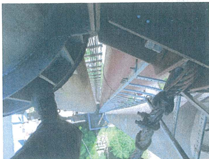
Fot. 7. Mocowanie dolnego odciągu do rury nośnej (trzonu)
