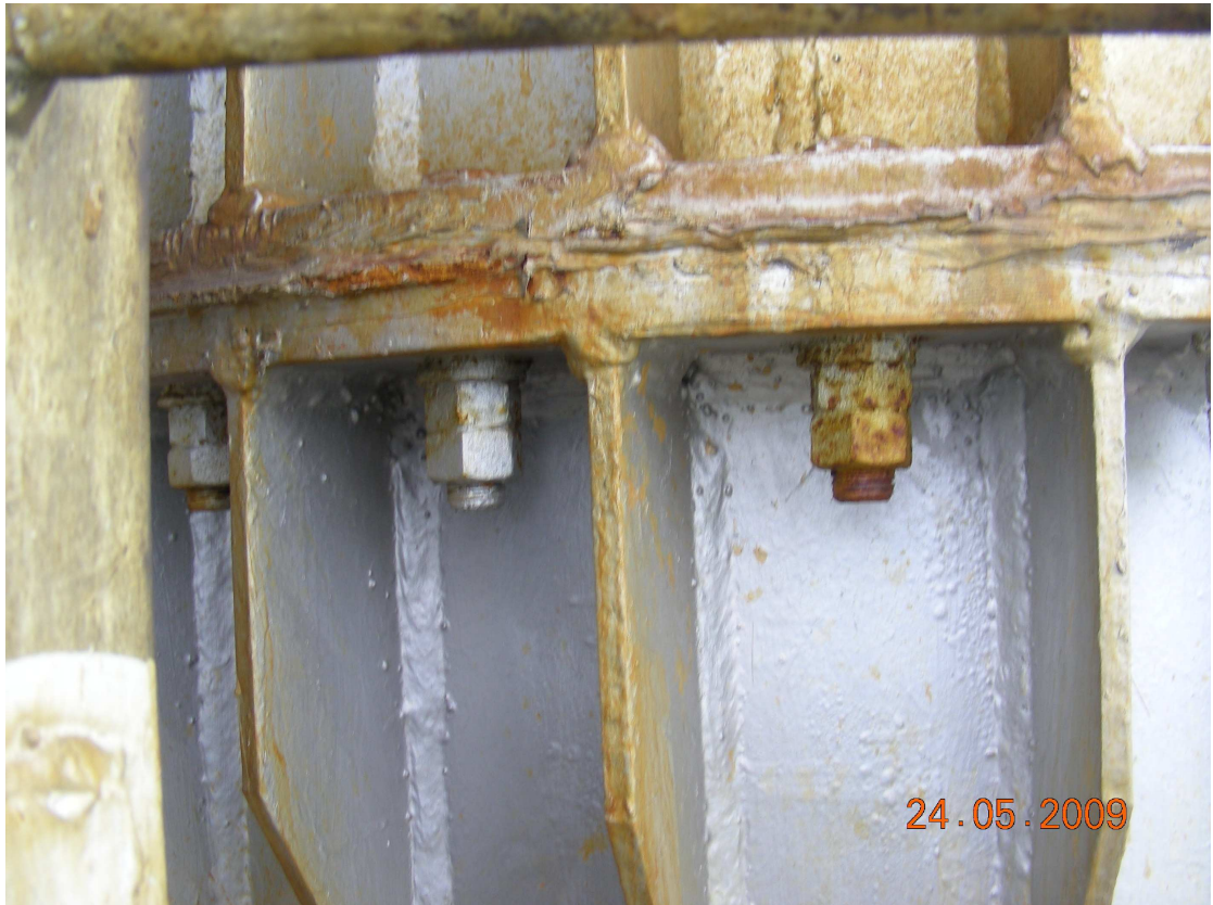
Fot. 9 Kołnierz komina gazowego lekko skorodowany.
