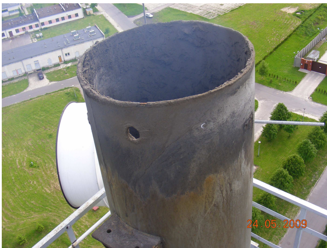
Fot. 4 Wylot przewodu węglowego nr 1..
