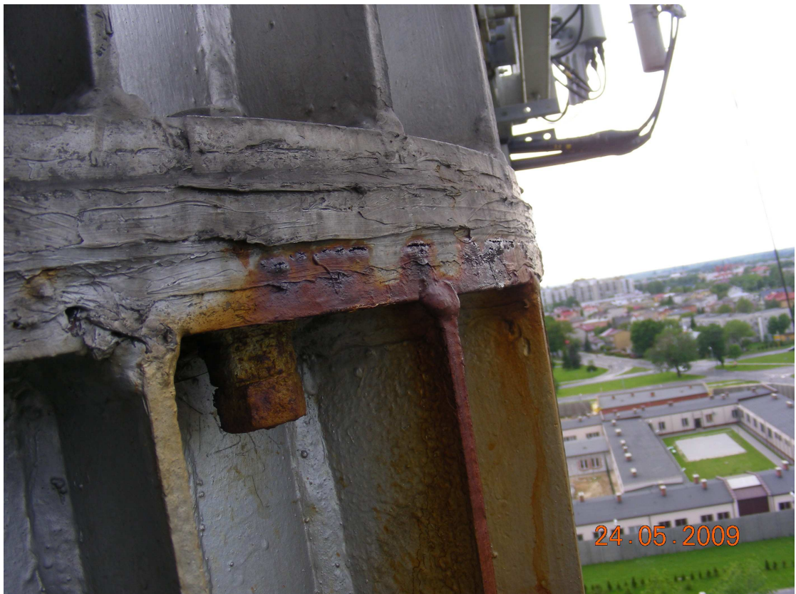
Fot. 10 Kołnierz komina gazowego skorodowany i rozszczelniony.
