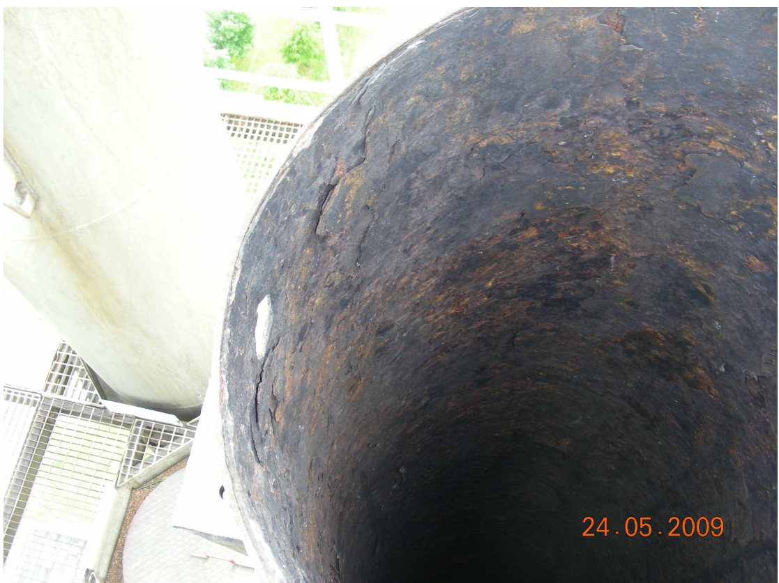
Fot. 6 Wylot przewodu gazowego nr 3..
