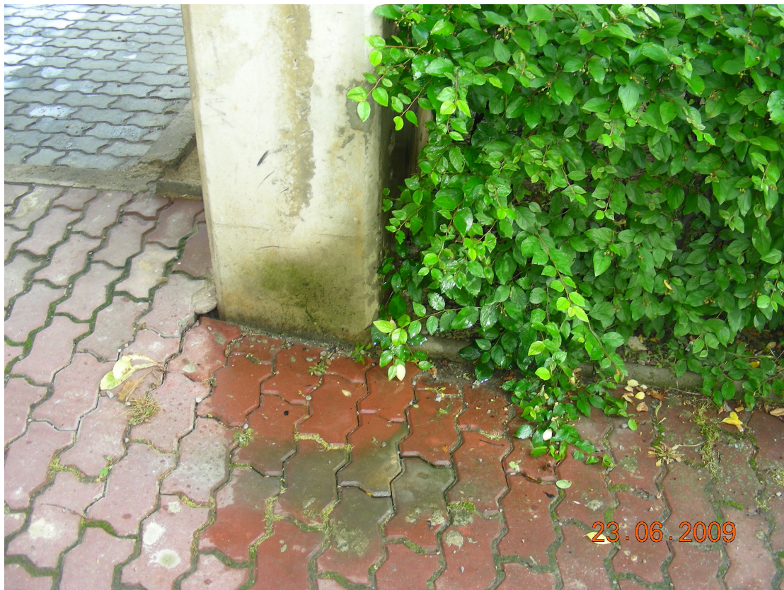
Fot. 12 Osiadanie kostki od przecieków z dylatacji.
