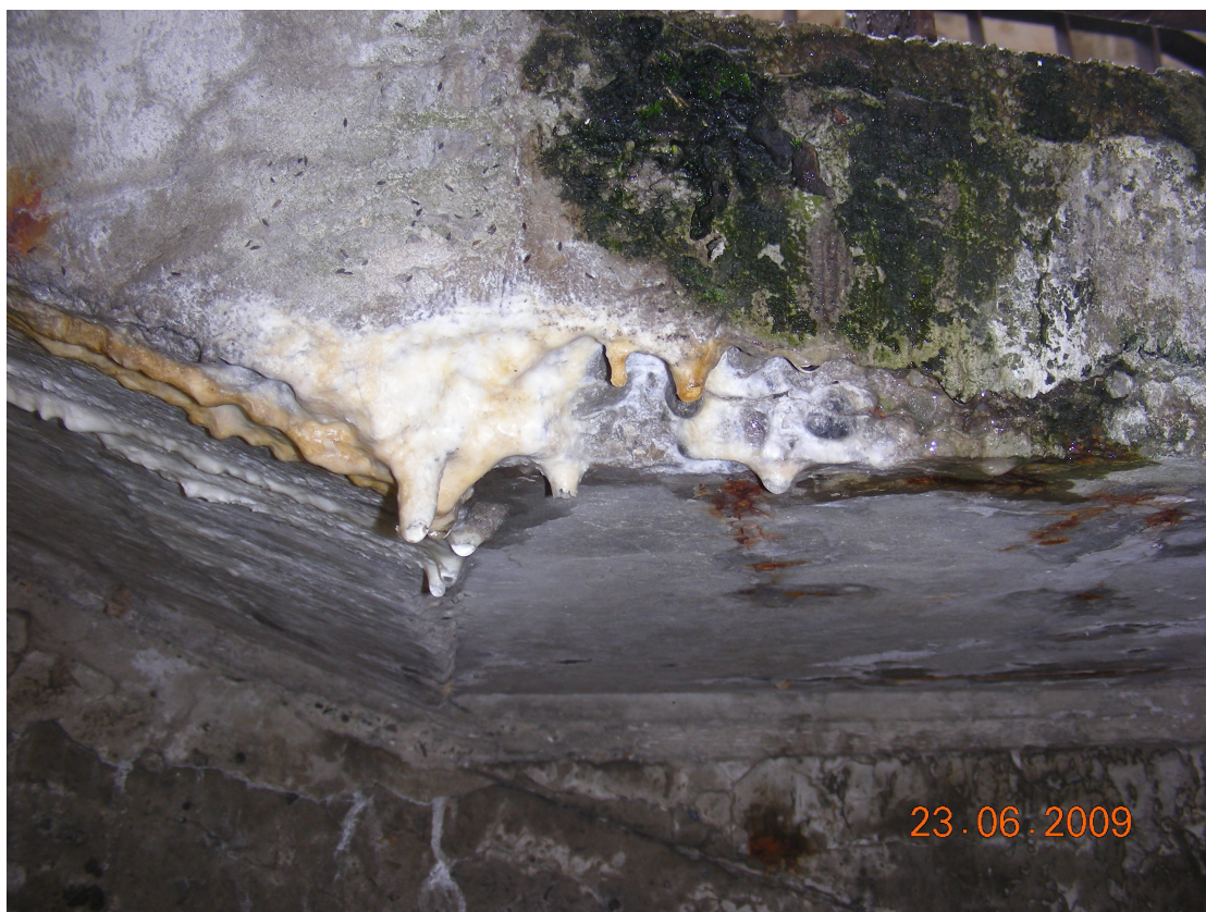
Fot. 6 Zasolenie konstrukcji żelbetowej w postaci „sopli”.
