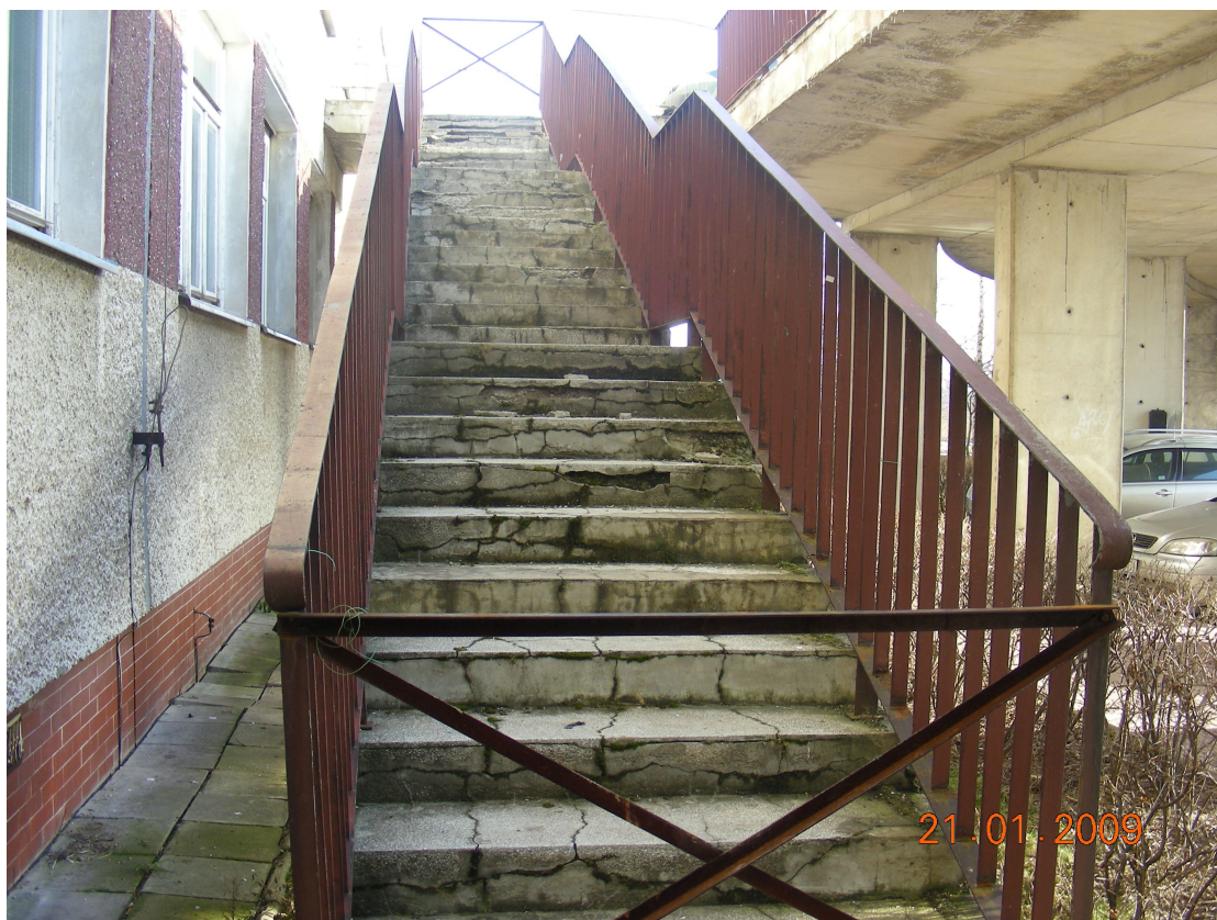
Fot. 9 Całkowite zniszczenie schodów.
