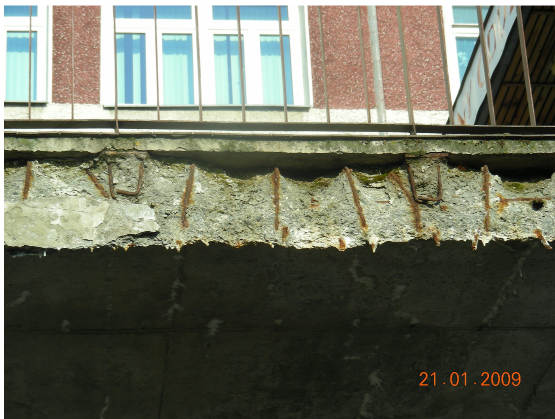
Fot. 3 Ubytki betonu i korozja zbrojenia.
